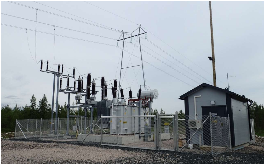
Kuva 4.9 Esimerkki tuulivoimapuiston sähköasemasta (FCG Finnish Consulting Group Oy).
